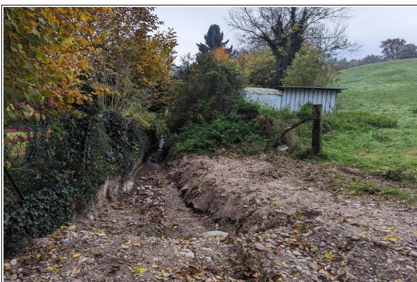
Figure V.14 : Au débouché de la combe de l'Ytras, la buse est submergée à chaque crue.
