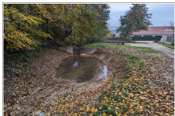
Figure V.15 : Premier bassin décanteur. Dans le cas d'embâcles sur la grille, l'ouvrage peut être submergé.
