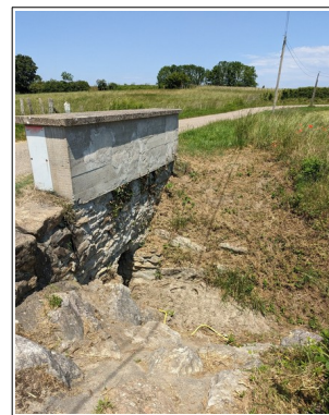
Figure V.31 : Passage busé sous la route au niveau de la zone humide de Fayolle.
