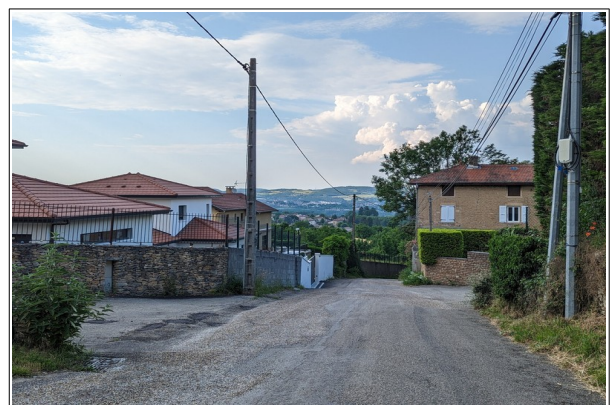
Figure V.27 : Un mur ayant été ouvert pour créer un portail, le ruissellement de la voirie a pu atteindre une propriété.
