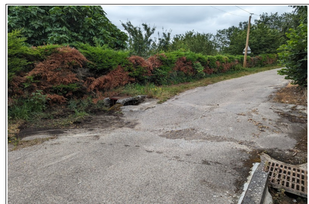
Figure V.21 : Passage busé sous la route qui connaît souvent des débordements.
